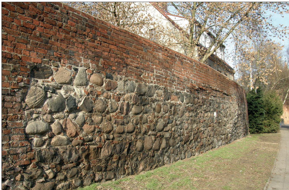
Ryc. 3. Fragment muru obronnego przy ul. Klasztornej, wg stanu z 6 marca 2013 r. Fot. A. Bierca, MAH w Stargardzie
